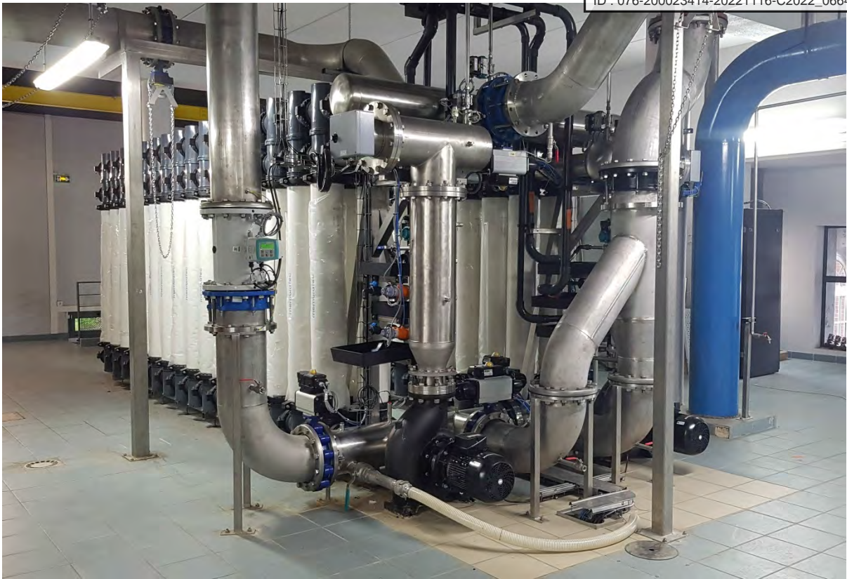
Nouvelle unité d'ultrafiltration – Usine de la Jatte ROUEN
